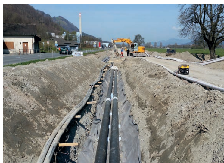
Preiswert, umweltfreundlich und lokal: Die KVA Linth baut ihr Fernwärmenetz stetig aus.
