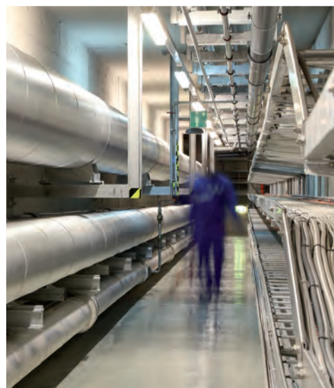
Moderne Anlagen zeichnen die KVA Linth aus.
