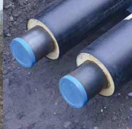
Vor- und Rücklaufrohr
