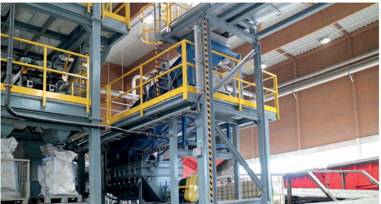
Pilotanlage Metallrückgewinnung < 2 mm
