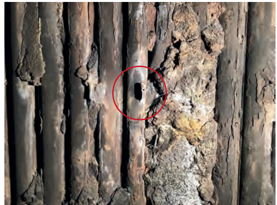
Schaden am Kesselrohr
