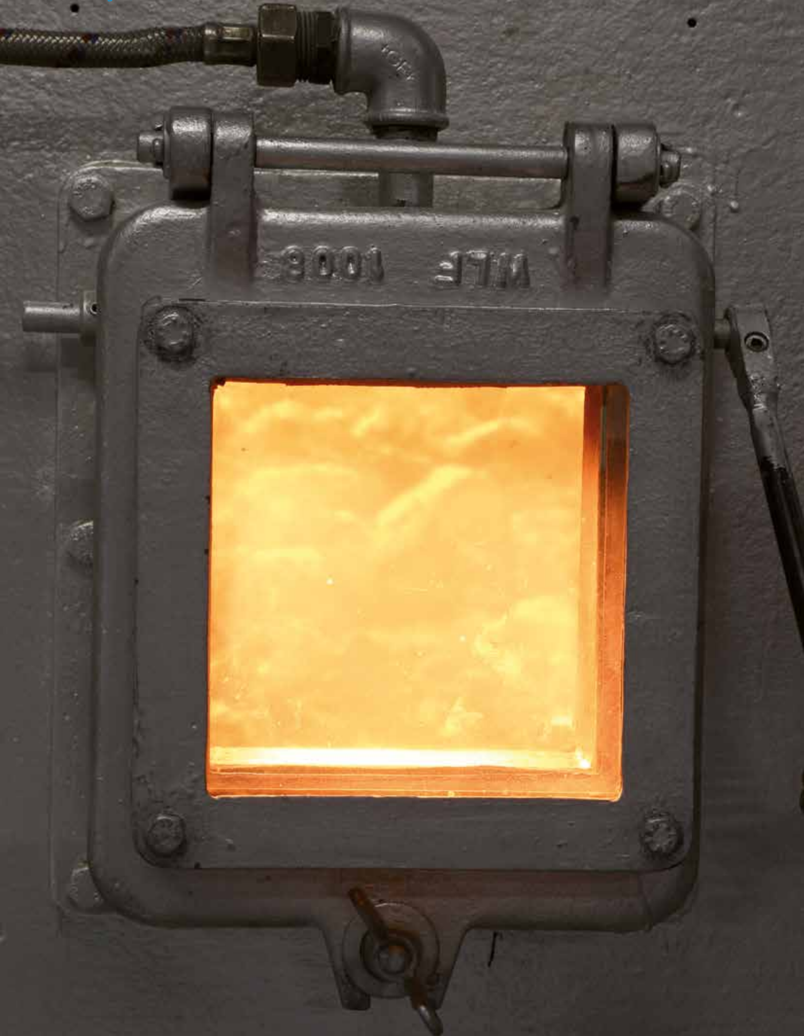
Blick in den Feuerraum
