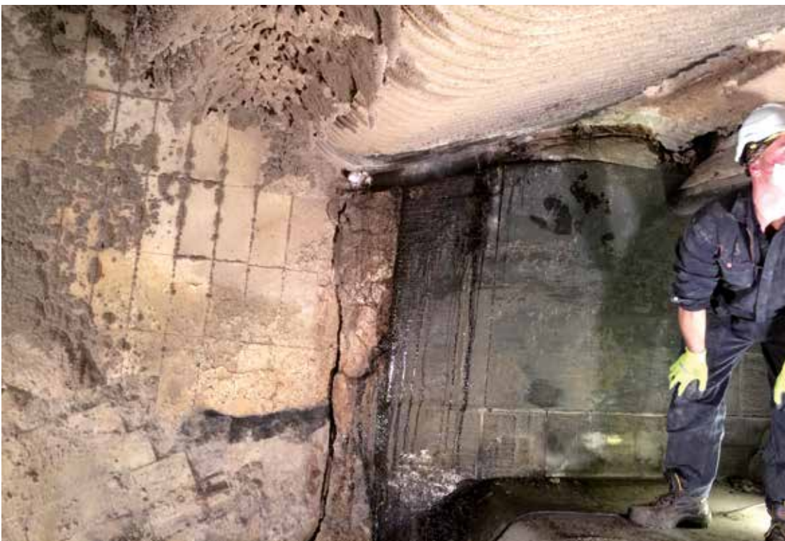
Schaden an der wassergekühlten Seitenwand / Beschickung Ofenlinie 2
