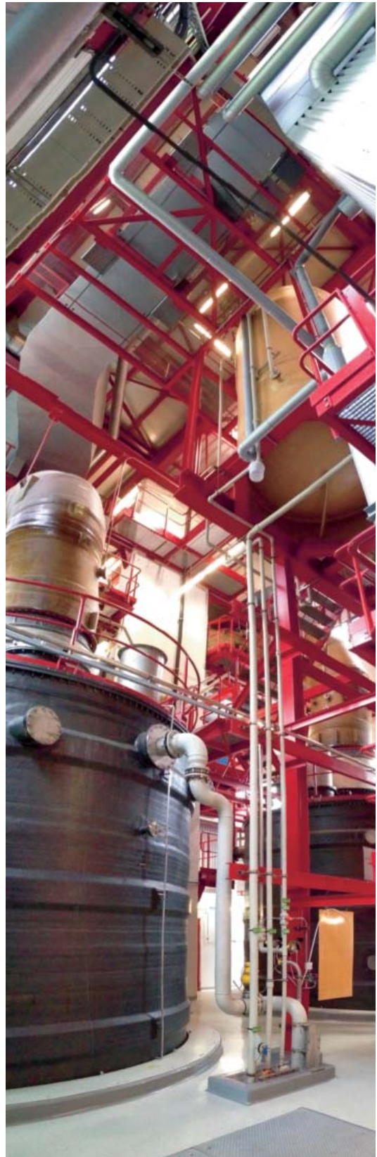
Nasselektrofilter und Notwassertank
