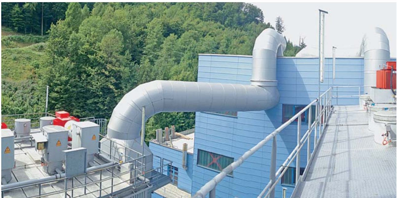
Elektrofilter und Rauchgaskanäle
