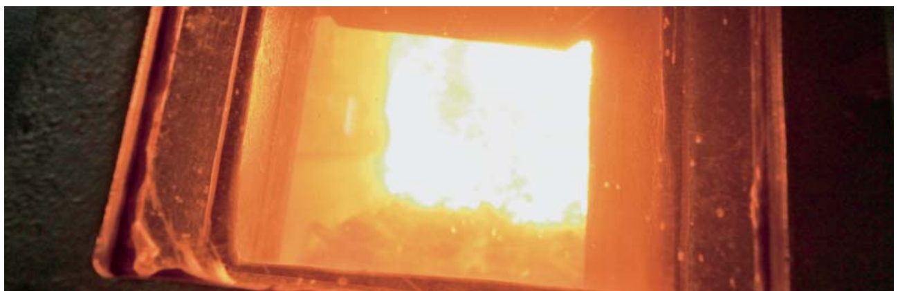
Blick in den Feuerraum
